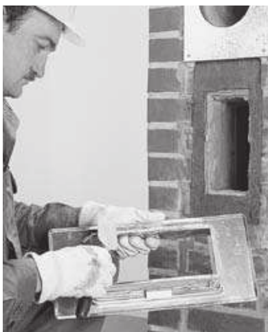
24 Viereckiger Putztüranschluss: Aufbiegen der Fixierlaschen an der Putztür und versetzen der Putztür mit Stützenkleber oder Muffenkitt. Runder Putztüranschluss: Mantelsteinverschluss einmörteln.
